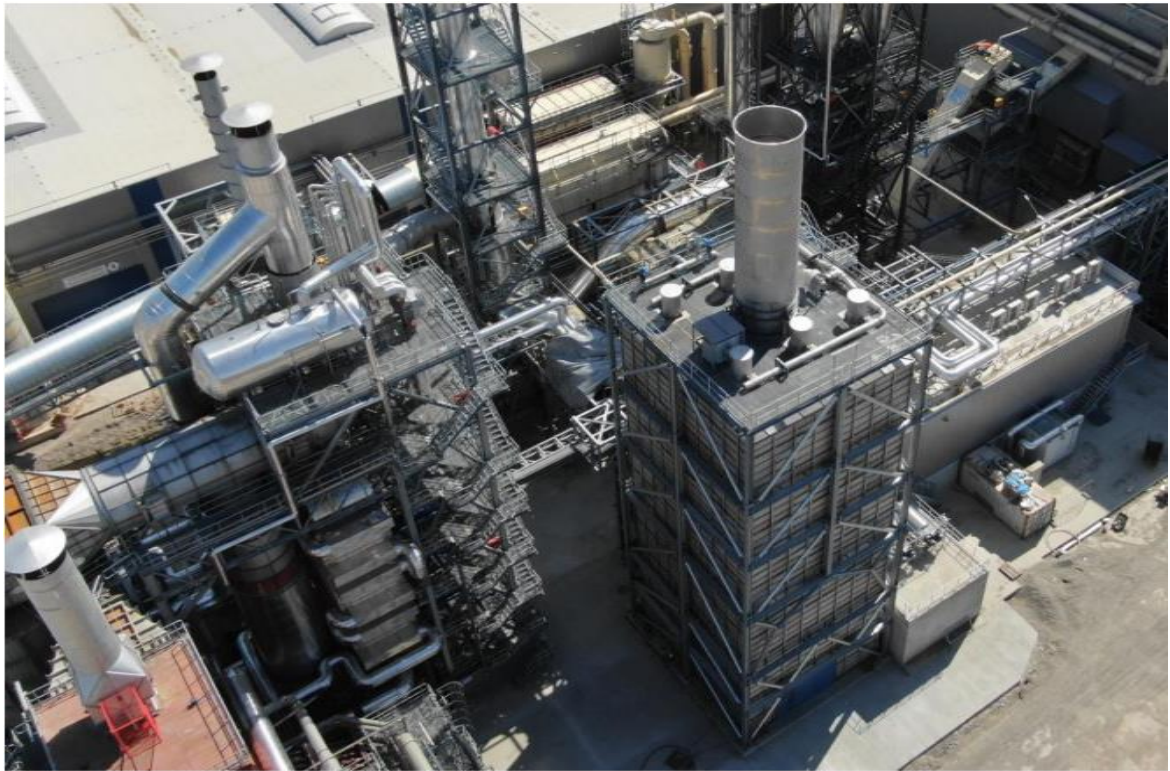
Рисунок 3.2 – Загальний вигляд системи очищення викидів
