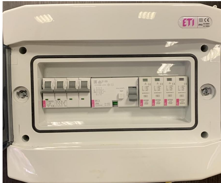
Рисунок 3.3 – Щит захисту змінного струму
