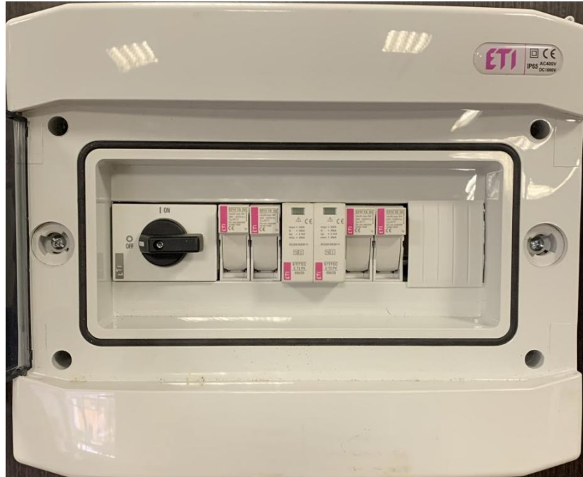
Рисунок 3.2 – Щит захисту постійного струму
