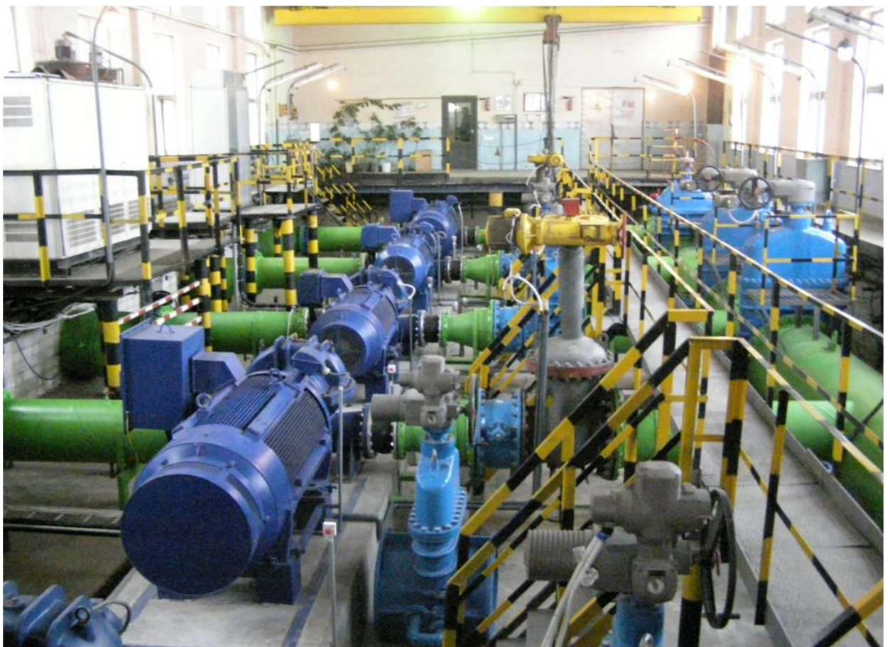
Рис. 3.2. Насосна станція "Сокільники"
