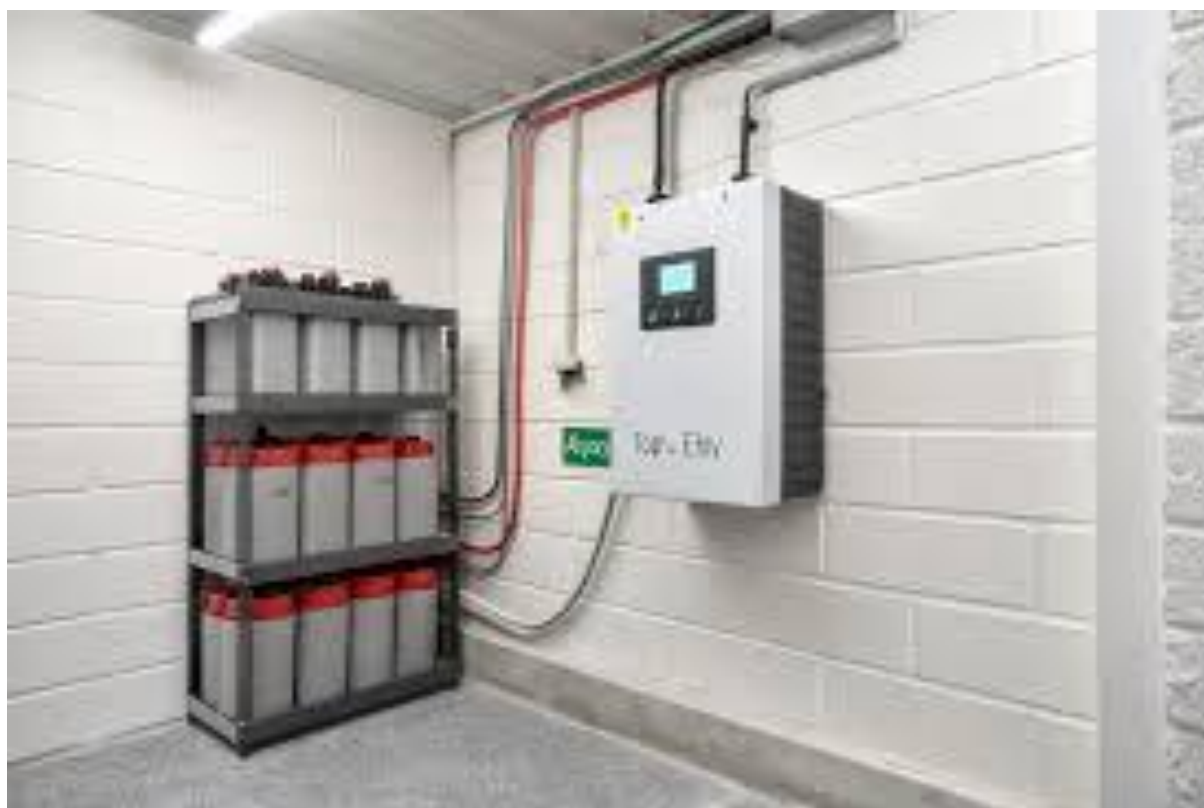
Рисунок 1.1 - Інверторні системи з акумуляторними батареями
