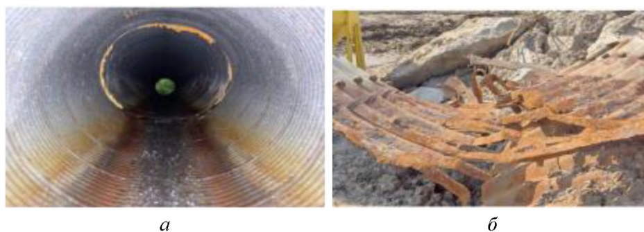
Рис. 2. Пошкодження МГК корозією в процесі експлуатації.
