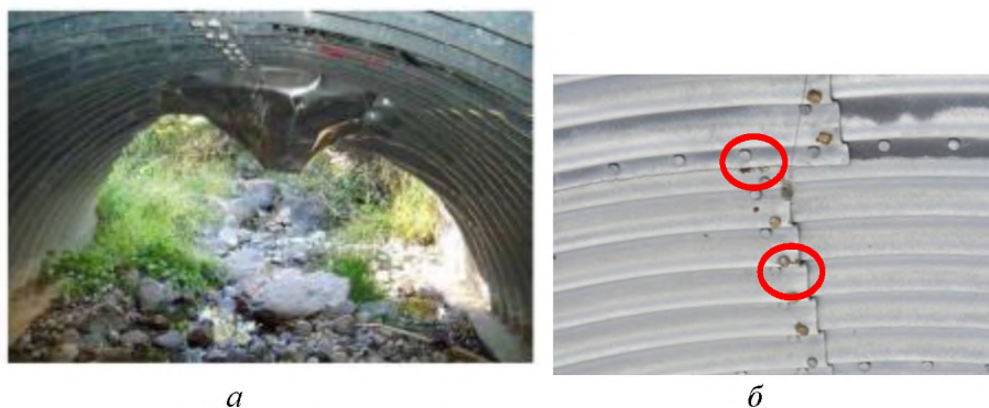
Рис. 1. Пошкодження металевих гофрованих конструкцій у процесі експлуатації: а – провисання склепіння труби із МГК та розвиток пластичного шарніру; б – викривування металу в зоні болтових з'єднань.
