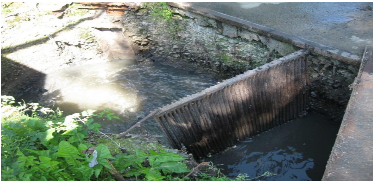
Рисунок 2.3 – Загальний вигляд ґратів у блоці механічної очистки
