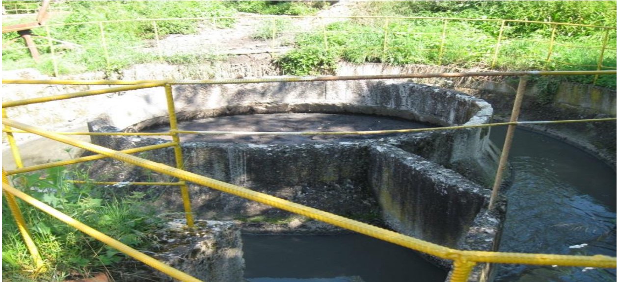
Рисунок 2.4 – Загальний вигляд пісכולовки у блоці механічної очистки
