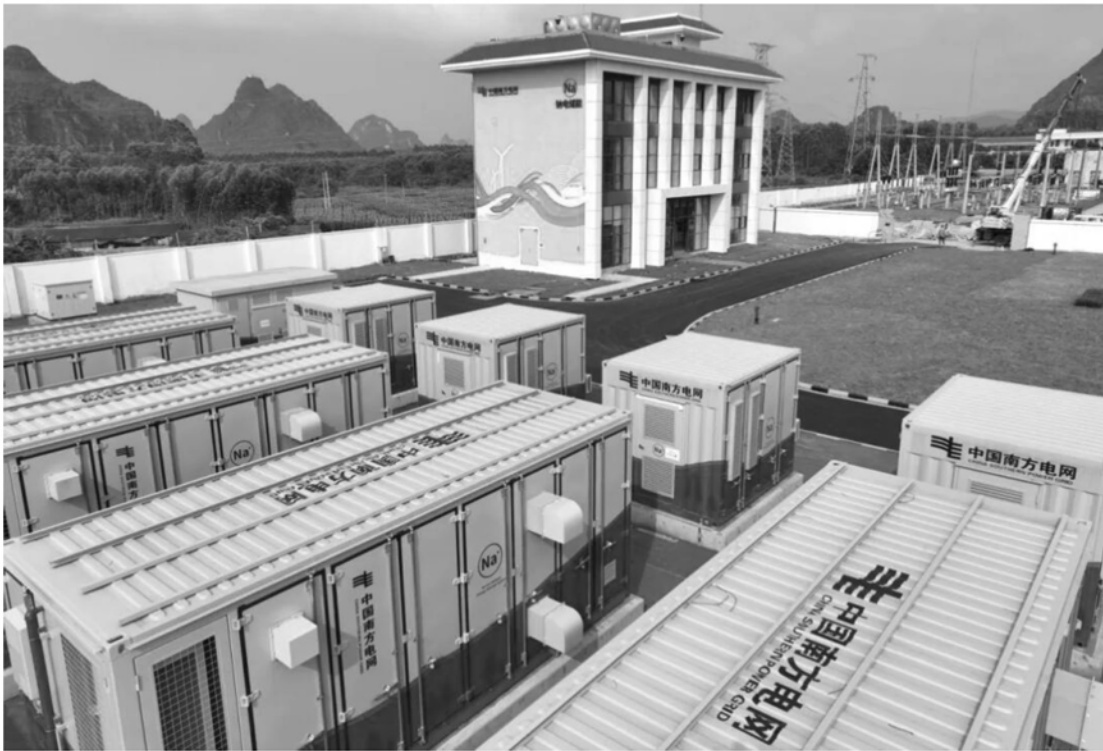
Рис.2.2 Комплекс Energy Storage Station із натрій-іонних батарей у Baoshi (провінція Юньнань), Китай.
