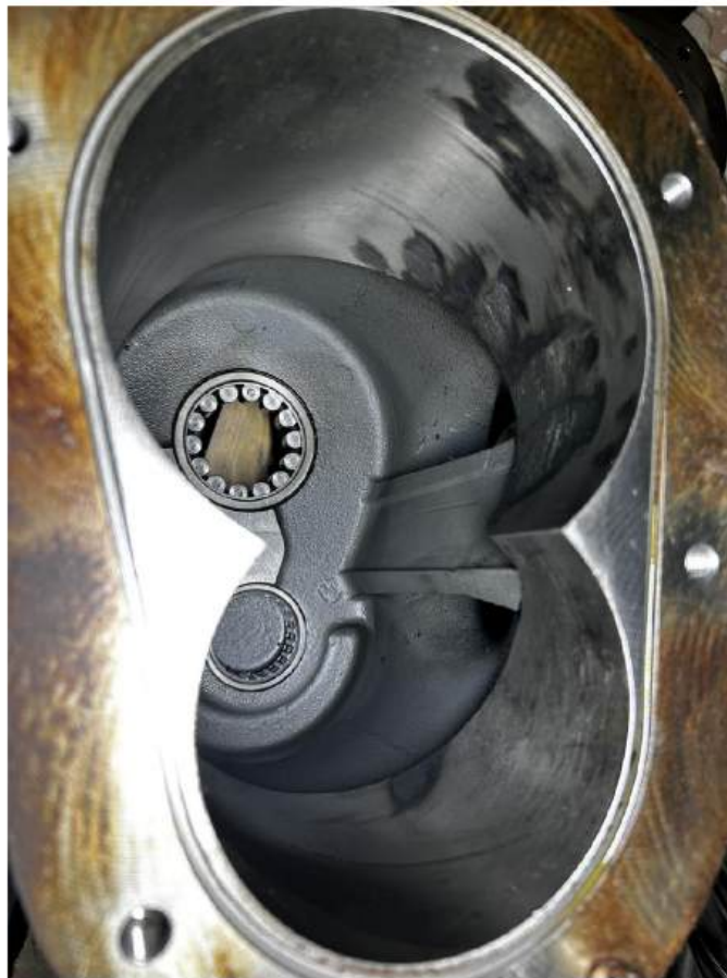
Рис.2.3 Аварійне спрацювання корпусу компресора
