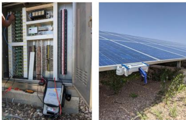
Рисунок 2.2 – Індикатор ВАХ підключений до розподільна коробка фотоелектричних батарей (ліворуч) і датчик сонячної енергії монтується до фотоелектричної струни (праворуч).
