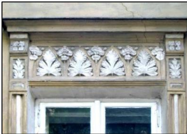
Рис. 3.74. Оздоблення вікон ліпниною на будинку на вул. Снопківській, 16
