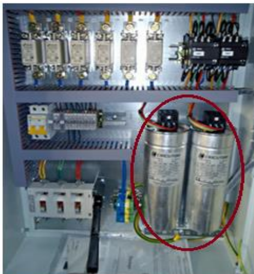
Рисунок 2.21 – Під'єднання компенсаційної батареї до електротехнічного обладнання
